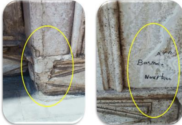
صورة (28-29) توضح التلف البشري وتشويه الأسطح بالكتابة عليها بعض الأسماء نتيجة لظفة الوعي الأثرى وعمليات الترميم الخاطئة عن طريق الاسمنت الأبيض
